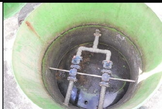
Chambre de vannes
