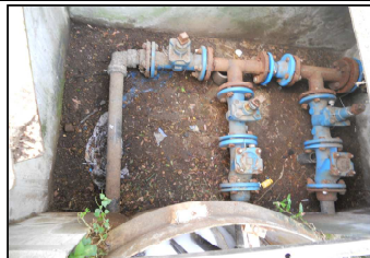
Chambre de vannes
