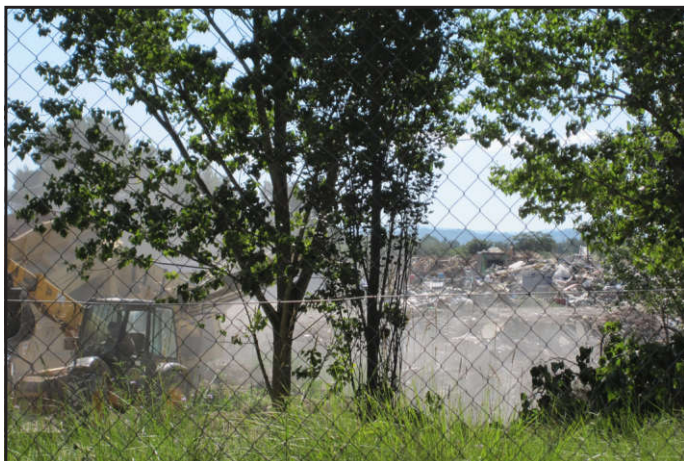
Activités liées au stockage d'inertes issus du BTP
