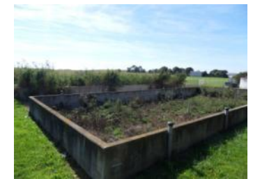
Station d'épuration Civrieux Bourg
