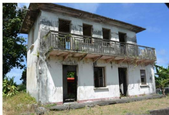
Logement abandonné, quartier Rivière Roche
