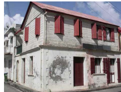
Maison de ville à R+1, fin 19 ème siècle, rez-de-chaussée en moellons et briques avec enduit, étage en bois.
