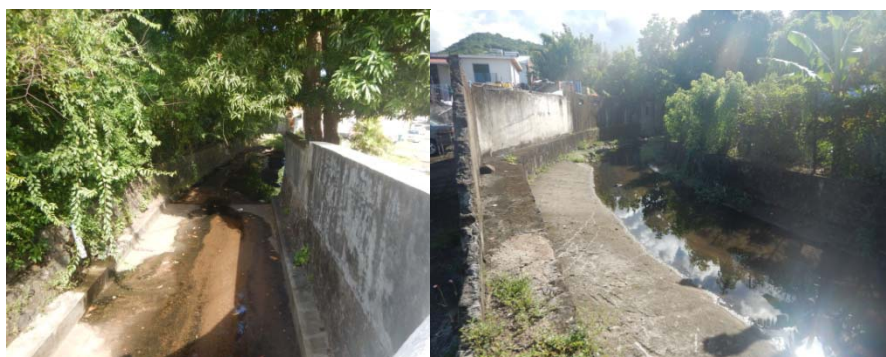
Ravine trouvant son exutoire au niveau du port de pêche dans le bourg de Case-Pilote
