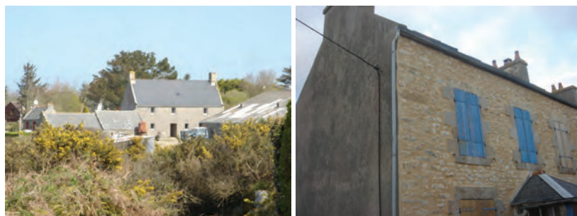
Façade appauvrie par un enduit ciment
