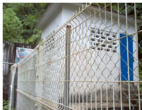
La prise d'eau en rivière de Bouliki
