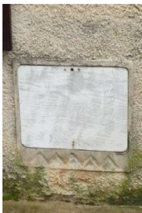
intégration d'un coffret réseau au nu du mur
