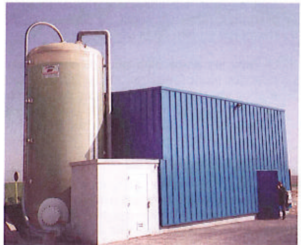
Unité de dénitratisation de Beaumont
