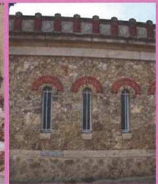
Utilisation de la pierre meulière avec des assemblages singuliers de brique et de pierre locale
