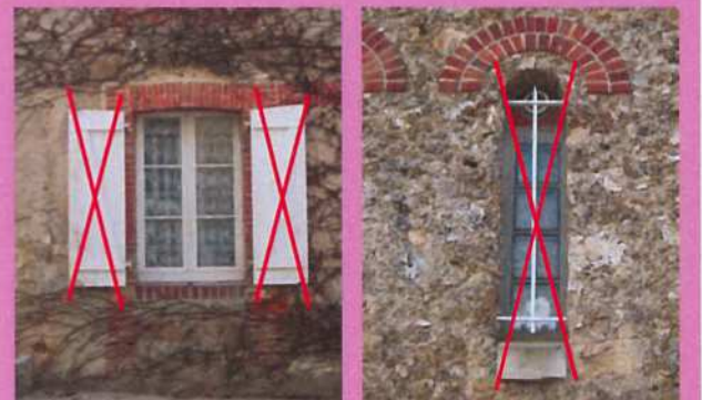
Menuiseries PVC épaisses et volets en écharpe sans dialogue avec l'architecture ancienne de la façade
