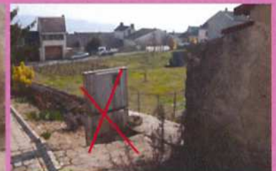
Eviter les coffrets, s'élevant sans support d'intégration (façade, muret...)
