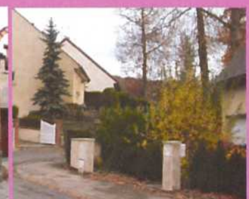
Coffrets EDF/GDF inclus dans le muret de clôture enduit au sein du Tissu récent
