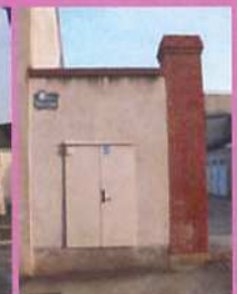
Armoire technique intégrée dans le mur de clôture
