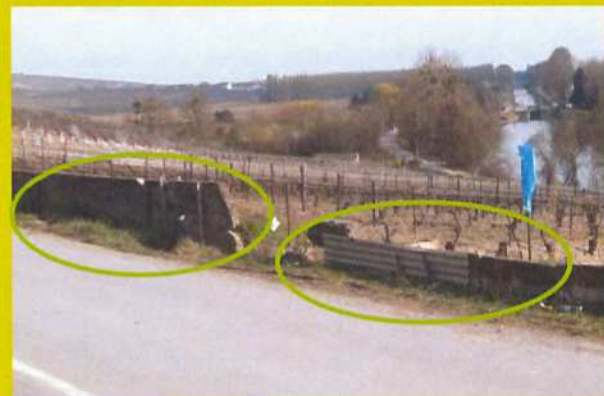
Des bordures de la D1 aménagées avec une juxtaposition de muret béton dégradé et de tôles ondulées rouillées détériorées
