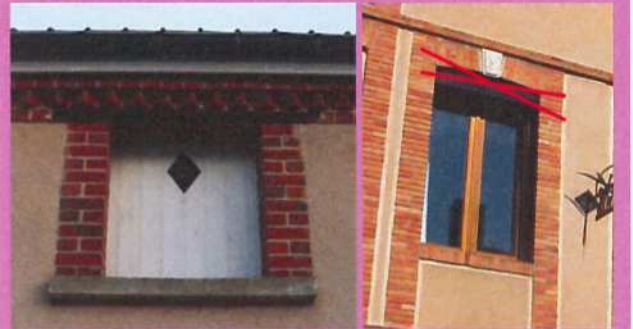
Une petite ouverture, fermée par une corniche ornée de briques, et remplie de lames verticales de bois peintes, percées d'un losange
