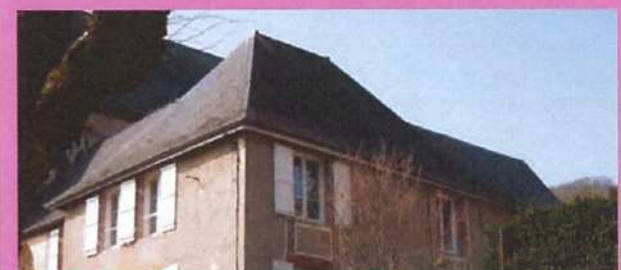
Une toiture remarquable à quatre versants en ardoise, comprise au sein de l'ensemble des édifices prestigieux de l'abbaye
