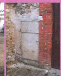
Emplacement pouvant accueillir un coffret
