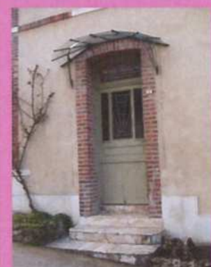
Marquise protégeant la porte d'entrée, peinte en vert pâle et ornée de ferronnerie sculptée
