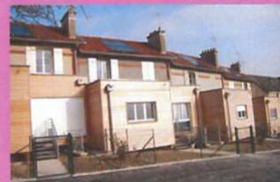
Nouvelles extensions de bois des maisons ouvrières rénovées à l'architecture contemporaine, bien intégrées
