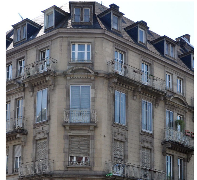
Les doubles menuiseries ont été remplacées par des châssis coulissants en aluminium (peu isolant) avec un dessin différent de celui d'origine © Région Grand-Est - Inventaire général
