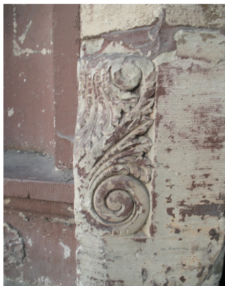
Élément de décoration en partie basse de piédroit présentant des traces de peinture. Le diagnostic préalable permettra de savoir si cette peinture est d'origine, si elle est compatible avec la pierre, s'il convient de l'enlever pour la bonne conservation de la pierre © Bailly-Leblanc
