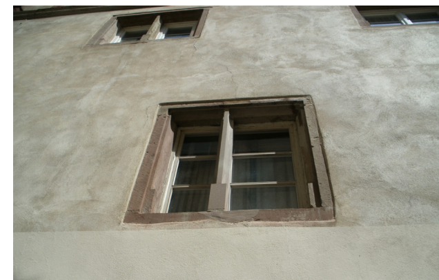
Restitution de trumeau de baies géminées médiévales dans une disposition fausse par rapport à celles d'origine et au schéma structurel. Le trumeau constitue un appui intermédiaire implanté dans l'axe médian du linteau pour en reprendre les forces © Bailly-Leblanc
