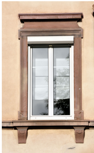
La pose de coffre de volets roulants sous le linteau, réduit la surface d'éclairage de la pièce. © Région Grand-Est - Inventaire général
