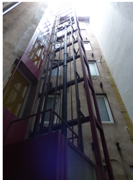
Structure d'ascenseur volumineuse dans une cour étroite et peu valorisante pour le voisinage ©Atelier G. André
