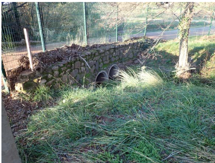
Figure 15 : Vue de l'ouvrage hydraulique busé du ruisseau de Creyssels situé en limite aval du camping (embâcles témoignant de la surverse lors d'une crue récente)
