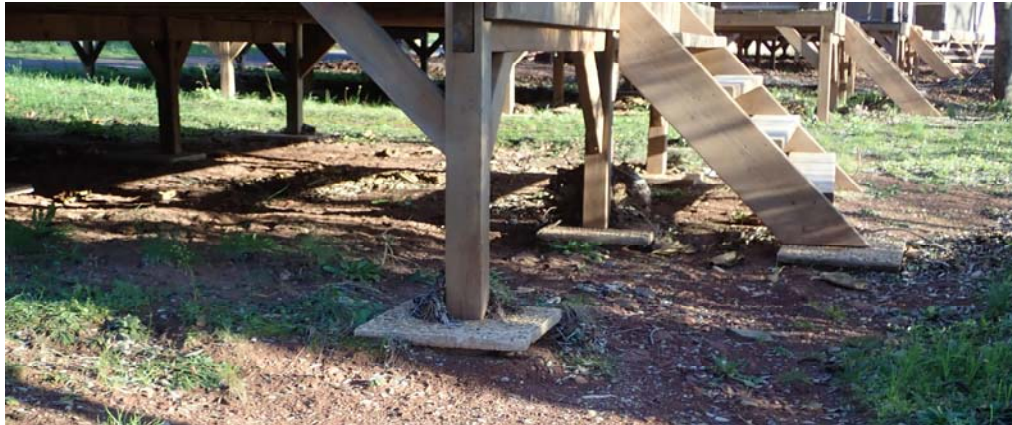
Figure 34 : L'égouttement autour des dalles de fondation de tente
