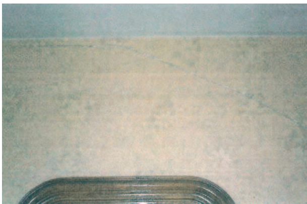
Fissuration intérieure, tapisserie déchirée - Maison André.
