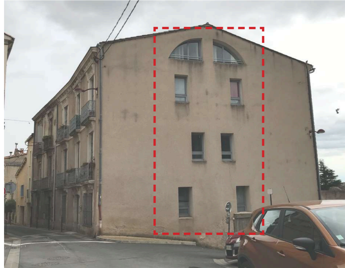
Percements peu intégrés dans un bâtiment historique, rue de la Frégère
