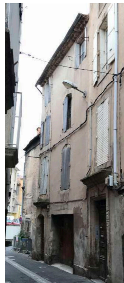
Immeuble avec problèmes d'enduits en façade
