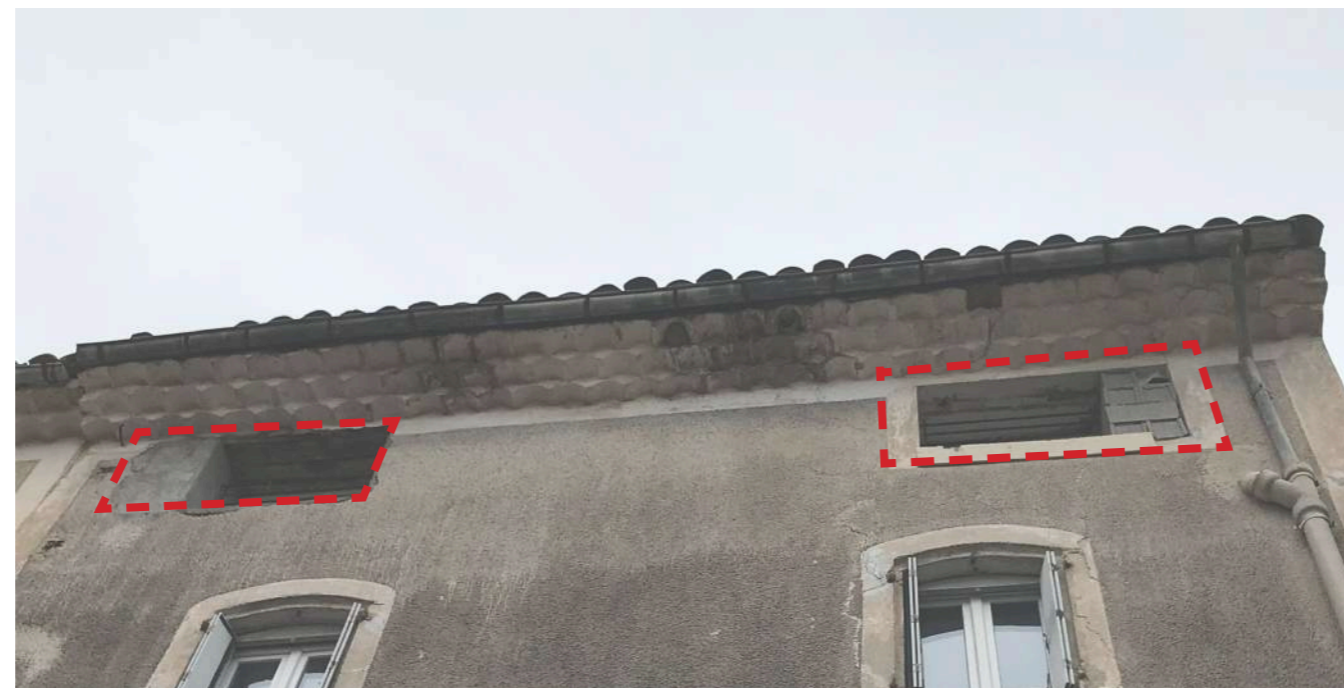
Bouchements partiels de baies très apparents
