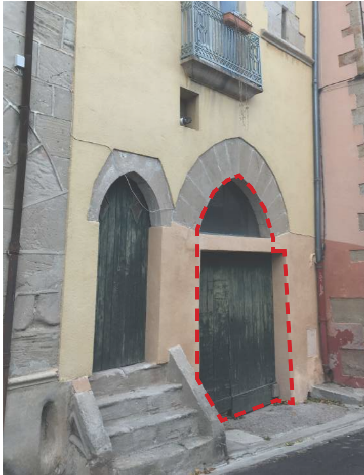
Ancienne échoppe avec percement dénaturé, rue Rougas
