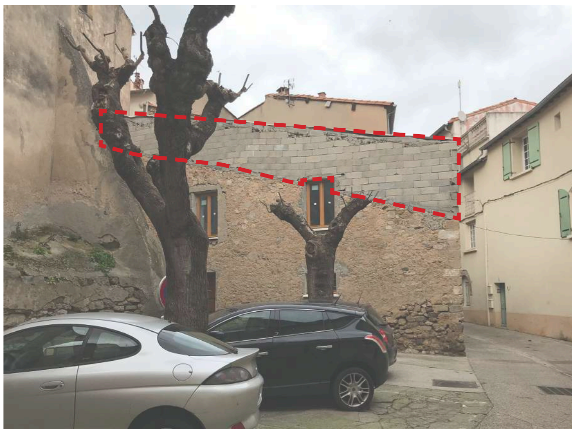
Extension verticale inachevée et abandonnée en parpaings, rue Filandière
