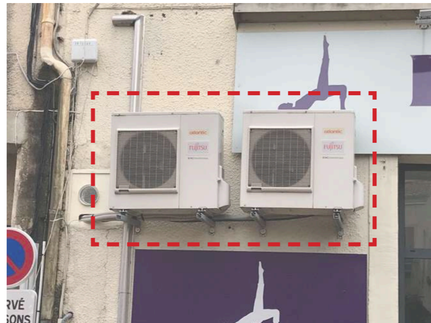
Réseaux de ventilation en façade
