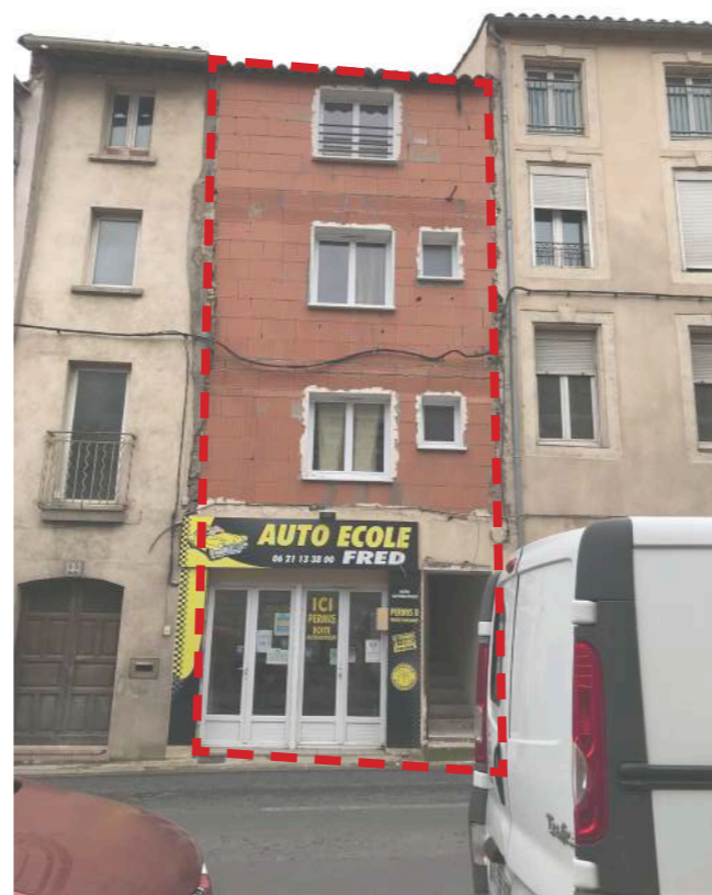
Façade inachevée et abandonnée en parpaings, rue de la Coutellerie
