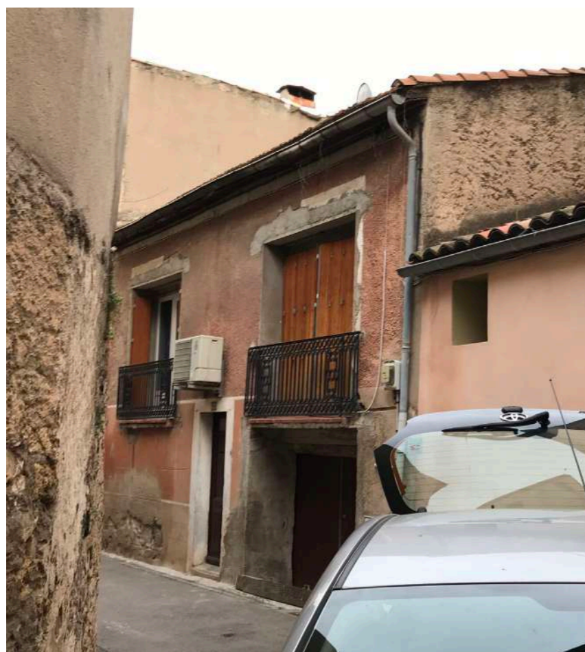
Maison avec problèmes d'enduits en façade
