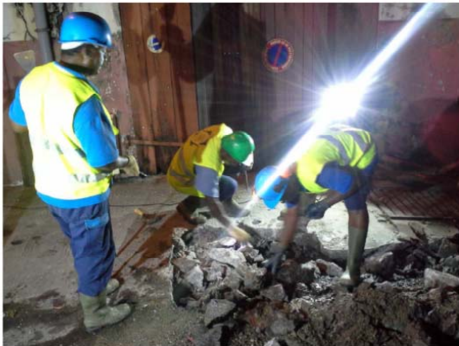
Janvier 2016 - Travaux de renouvellement de vannes dans le bourg de Saint-Pierre - Jour et nuit, la SME travaille pour le bien-être de ses clients -
