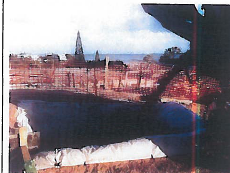
Bassin de décantation des laitances de béton
