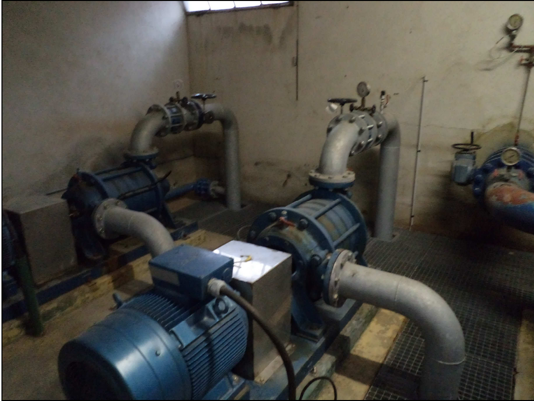
Figure 4-34 : Pompes station La Gardy vers Mourre de Cabus
