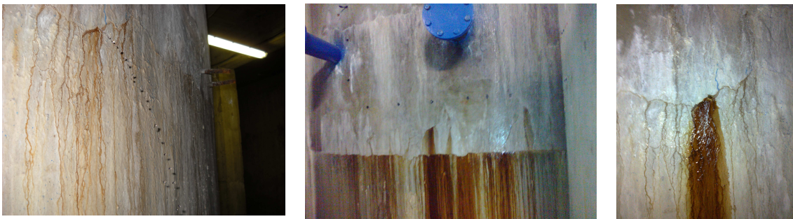
Figure 4-26 : Aspect extérieur de la bâche de 300 m 3 - suintement permanent de l'eau traitée
