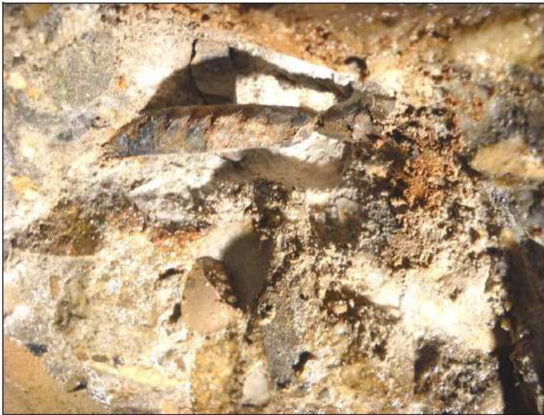
Figure 4-30 : Photos de la sous-face de la dalle de couverture du 700 m 3 issues du rapport CONCRETE -2009
