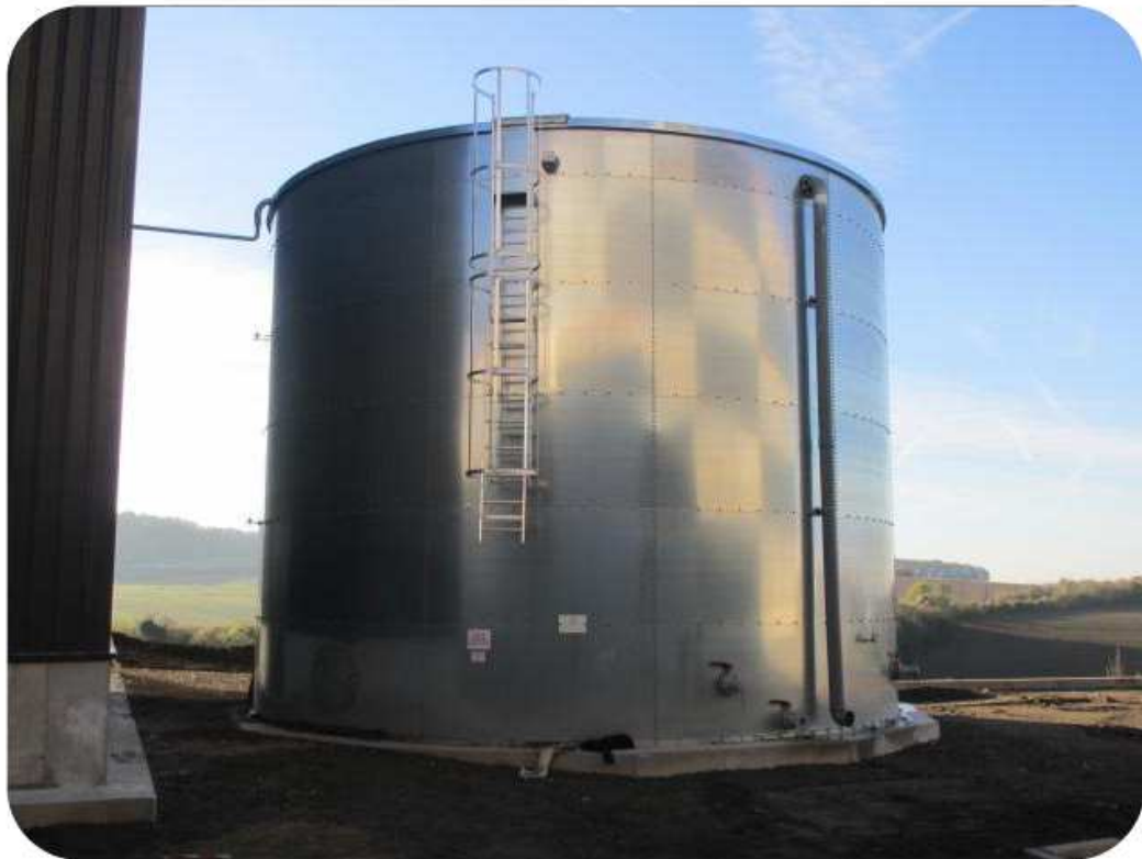
Figure 4-21 : Photographie d'un réservoir métallique
