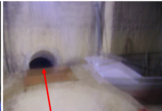
Évacuation de l'eau traitée perdue
