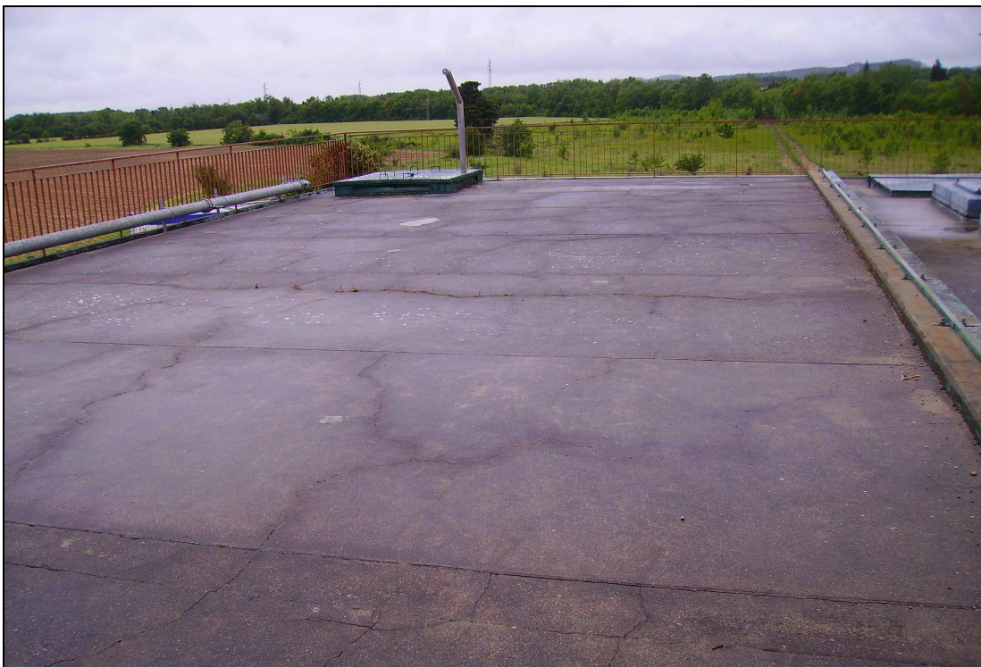
Figure 4-28 : Vue du toit de la bâche de 700 m 3 - dalle fissurée – 21 mai 2012
