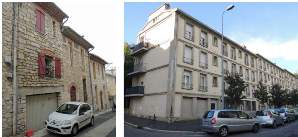
La mise en place d'une ITE sur une des façades alignées porterait atteinte à la qualité de la séquence urbaine.
