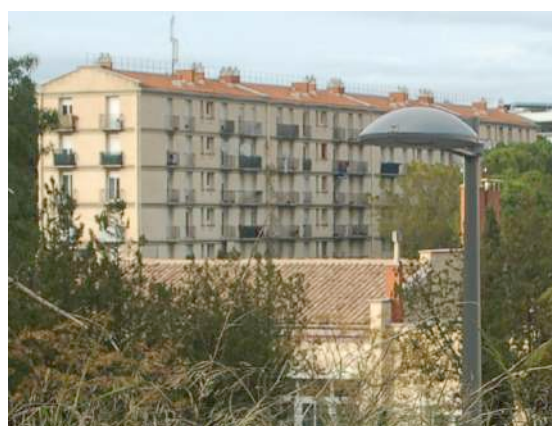
Cité Astruc Toit en tuiles peu reman
