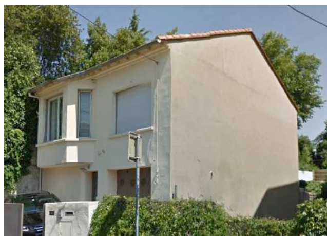
La mise en place d'une ITE sur certains murs pignons est parfois envisageable selon la modénature et la possibilité de faire disparaître les rives techniques latérales et hautes.
