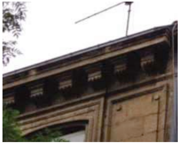
11 et 13 avenue du Pont Juvénal Corniche à modillons en pierre de taille Les corniches supportent des chéneaux en zinc
