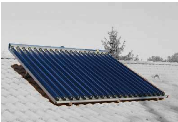
Capteurs solaires thermiques
