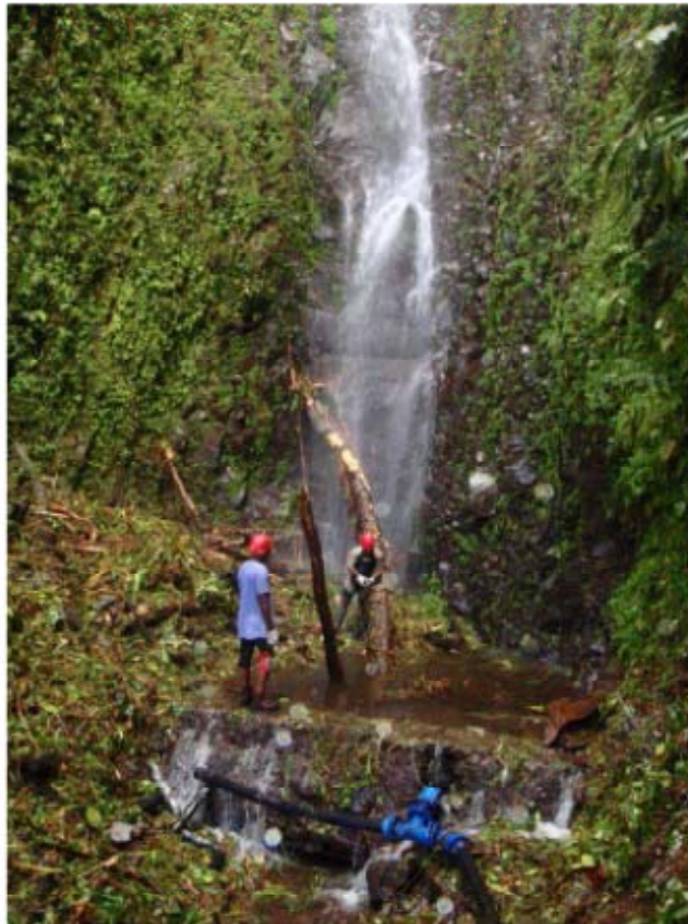
Eboulement sur le captage de Verrier (Bellefontaine) - 7 janvier 2015
