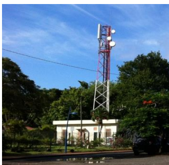
Pylône de télécommunication
