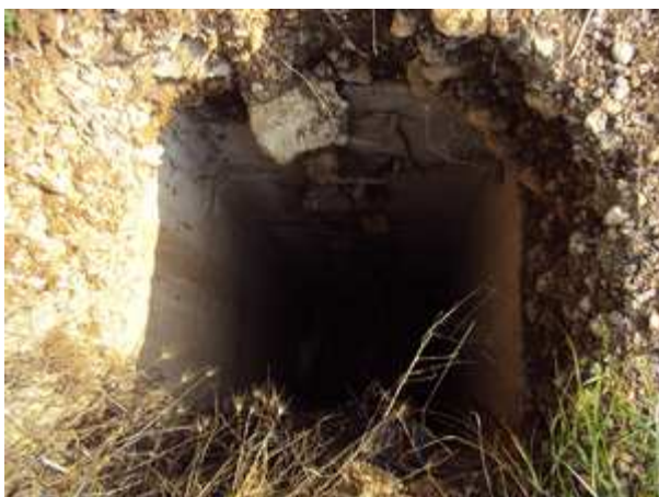
Vue du regard SUD 008 – Comblé par des matériaux de destruction de la clinique
