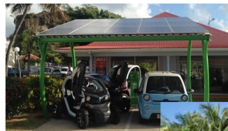
Station de recharge solaire pour véhicules électriques (ci-dessous).
