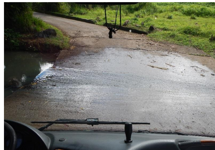
Exemple de la rivière Bêtes Rouges dont le lit est concerné par un passage à gué. L'écoulement de l'eau et le déplacement des espèces est donc fortement impacté.
