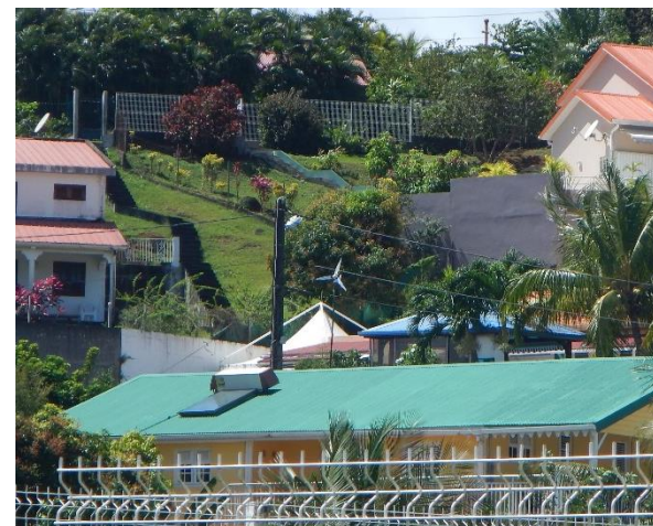
Eolienne individuelle installée sur un logement à Petit-bourg Source : EVEN Conseil – Avril 2016
