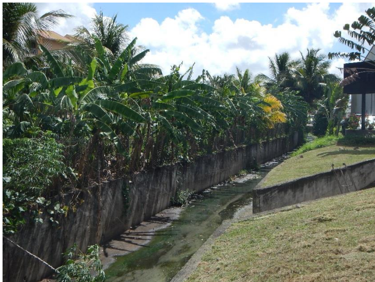
Exemple de la Ravine de la Laugier dont le lit a été entièrement comblé et imperméabilisé pour limiter les inondations de la zone d'activité qu'elle traverse. Le cours d'eau n'assure plus ses fonctions d'habitat.
