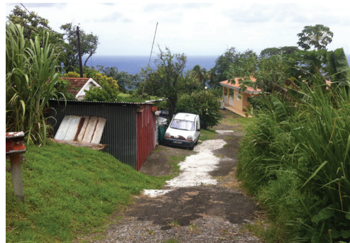
Petite route dégradée : accès au quartier de Beauséjour depuis la RD10.
