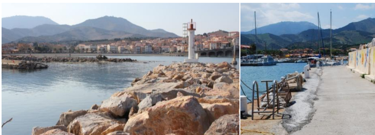
Digue endommagée en entrée de port de Banyuls-sur-Mer. Pontons défectueux
